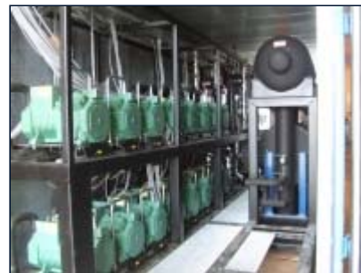
Den nye varmepumpe på Frederikshavns Forsyning er endnu ikke en uge gammel.
