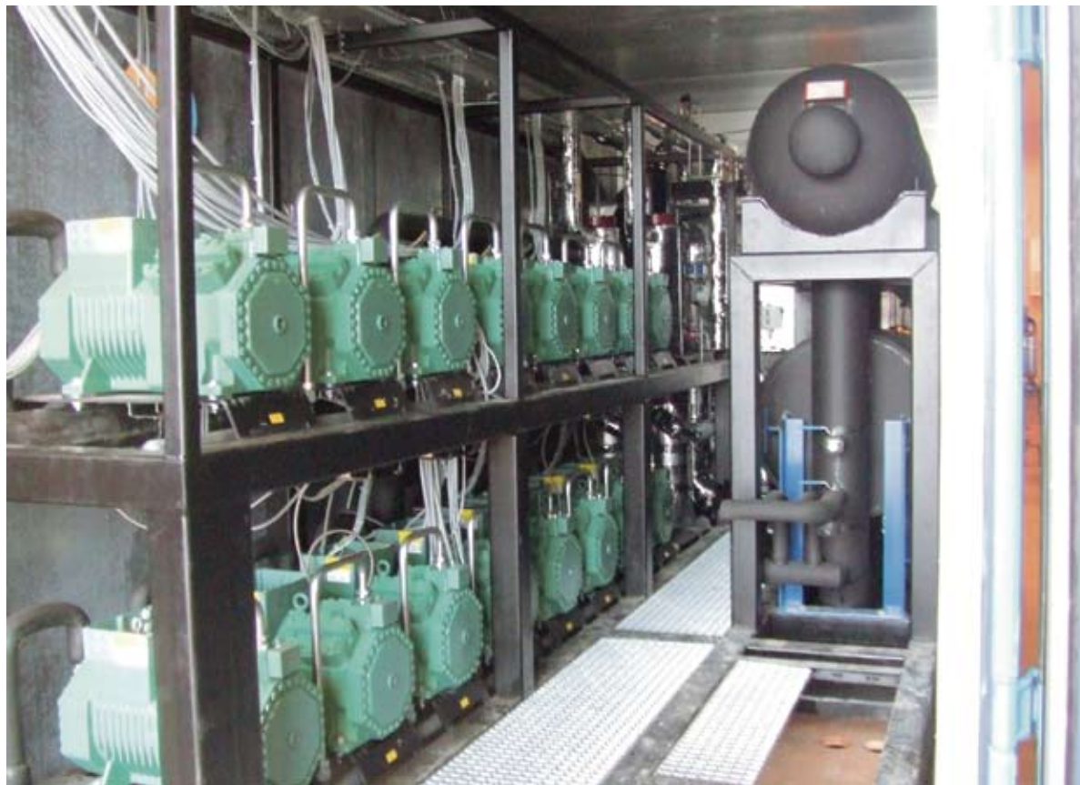
VARMEPUMPER er en metode til udnyttelse af overskudsstrøm fra vindmøller, der holder energien her i landet. Danmarks første elektrisk drevne varmepumpe i forbindelse med et kraftvarmeanlæg (billedet) blev sat i gang 3. august i år hos Frederikshavns Forsyning. Pumpens 16 elmotorer kan startes enkeltvis. Foto: Advansor, Århus
